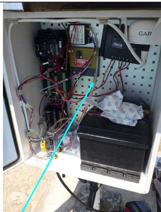
Un tube va directement du capteur de pression vers l'extérieur de la station via un filtre hydrophobe pour limiter les entrées d'air et donc d'humidité.
