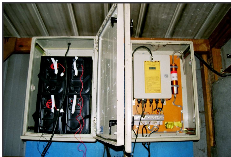
Figure 10 : Station de Saint-Paul à l'intérieur de la cabane. On peut voir dans le coffret de droite, la DSU (jaune) et le capteur de pression (rouge). Les piles dans le coffret de gauche sont stockées à la verticale ce qui entraîne des coulures. Elles seront placées à l'horizontale après le changement.
