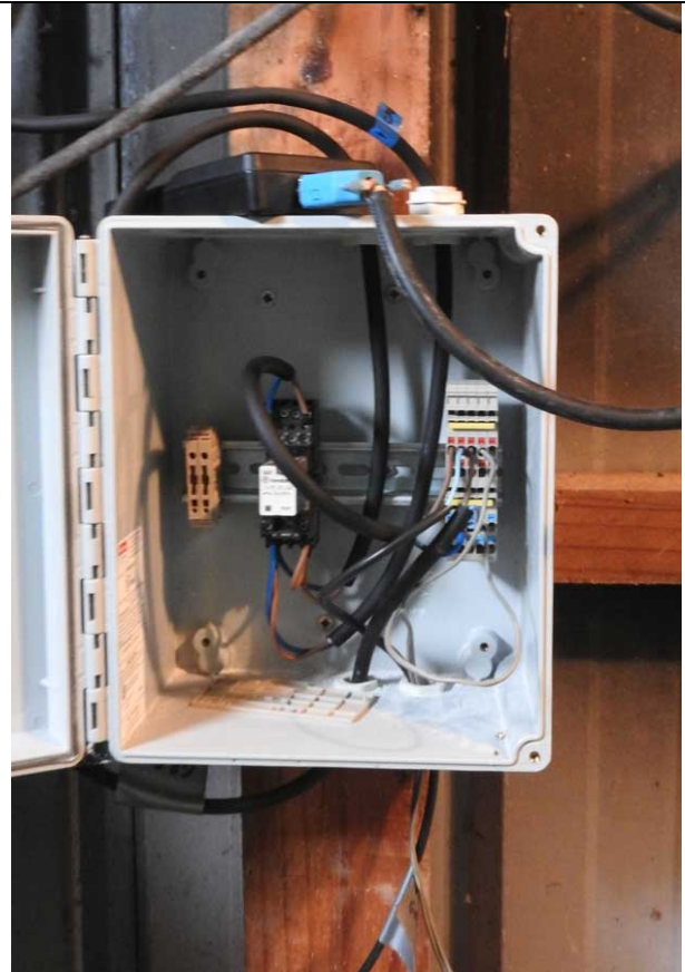
Boite de jonction où sont déjà raccordés la station SPA01 ; le GPS. La nouvelle station sismomètre le sera pendant cette mission.
