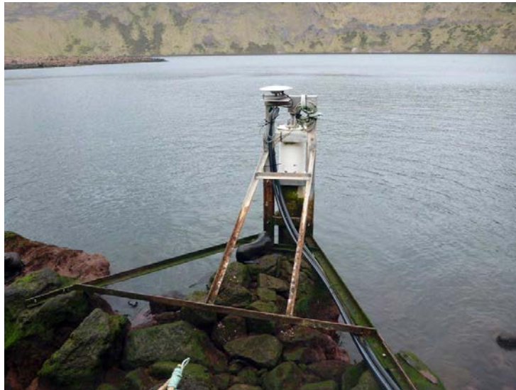
La structure en acier galvanisé est bien corrodée
