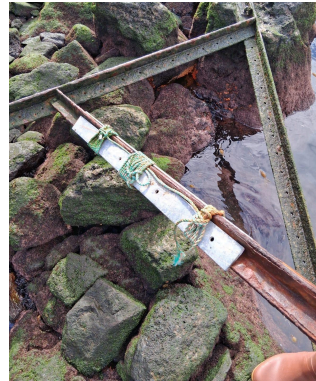
Figure 45 Plaque rajoutée pendant une précédente mission pour consolider la cornière gravement rouillée.
