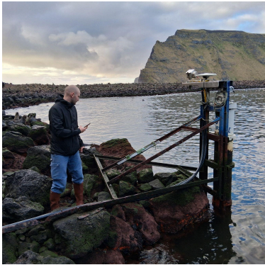
Figure 44 Inspection de la structure en acier à notre arrivée. Les parties immergées sont plus attaquées. La potence en inox rajoutée pour le radar aérien est en très bon état.
