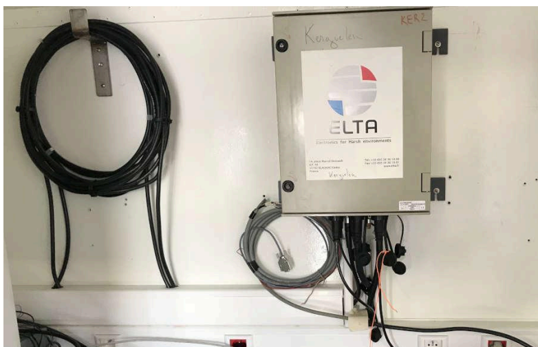
Figure 26 Les adresses internet de la station KER2 sont inscrites à l'intérieur de la porte :
