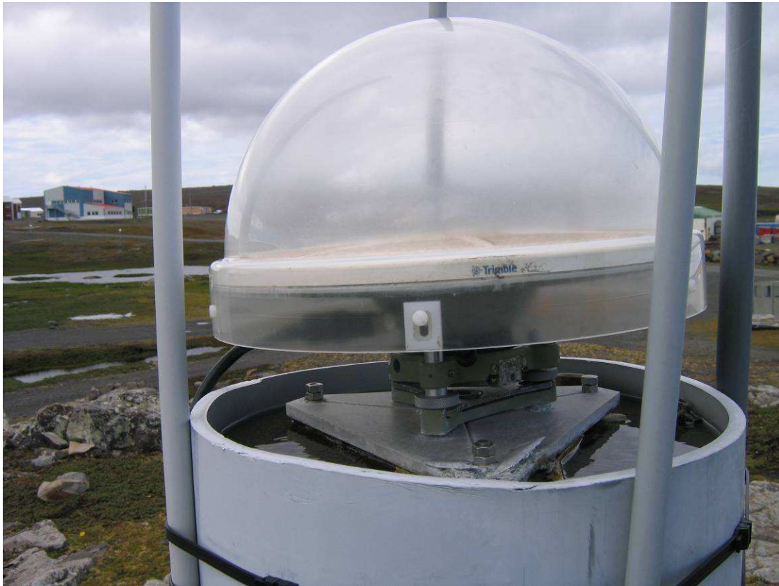
Vue de l'antenne GPS sur le pilier NIVMER
