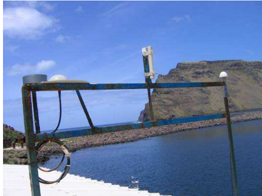
Vue de l'antenne GPS active, à droite du portique
