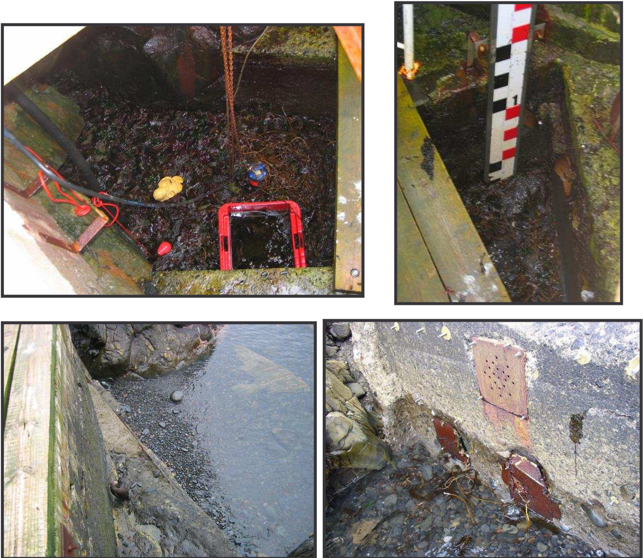
Figure 13 : Vues de l'intérieur (en haut) puis de l'extérieur (en bas) de l'échelle de marée (le tout à marée plus ou moins basse)
