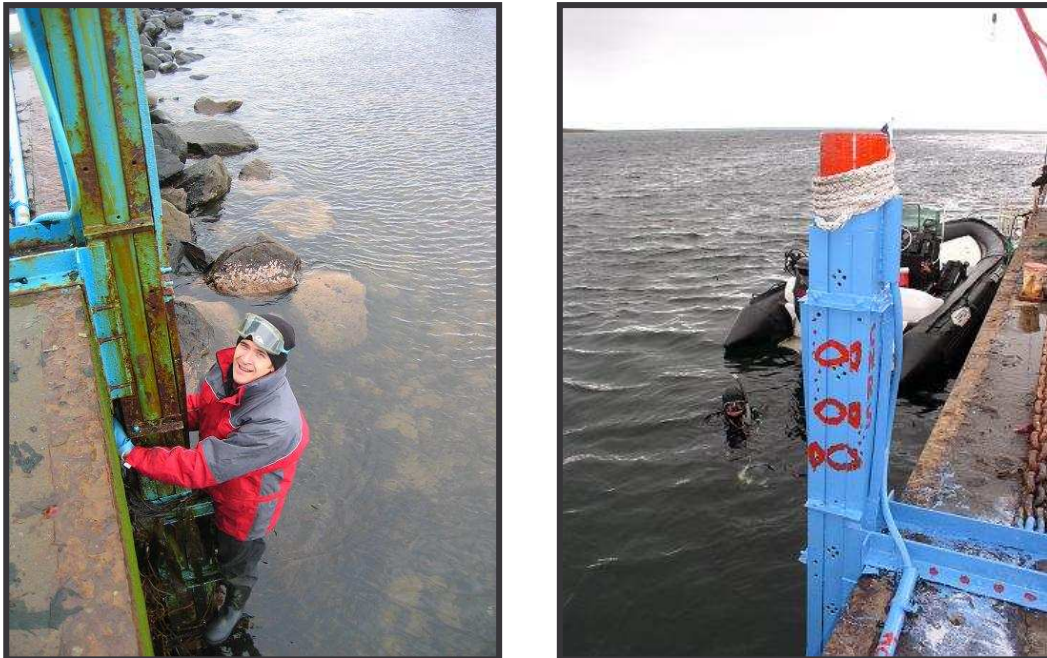
Figure 11: Marégraphe côtier de Kerguelen avant... et après... la repique de la rouille et la peinture
