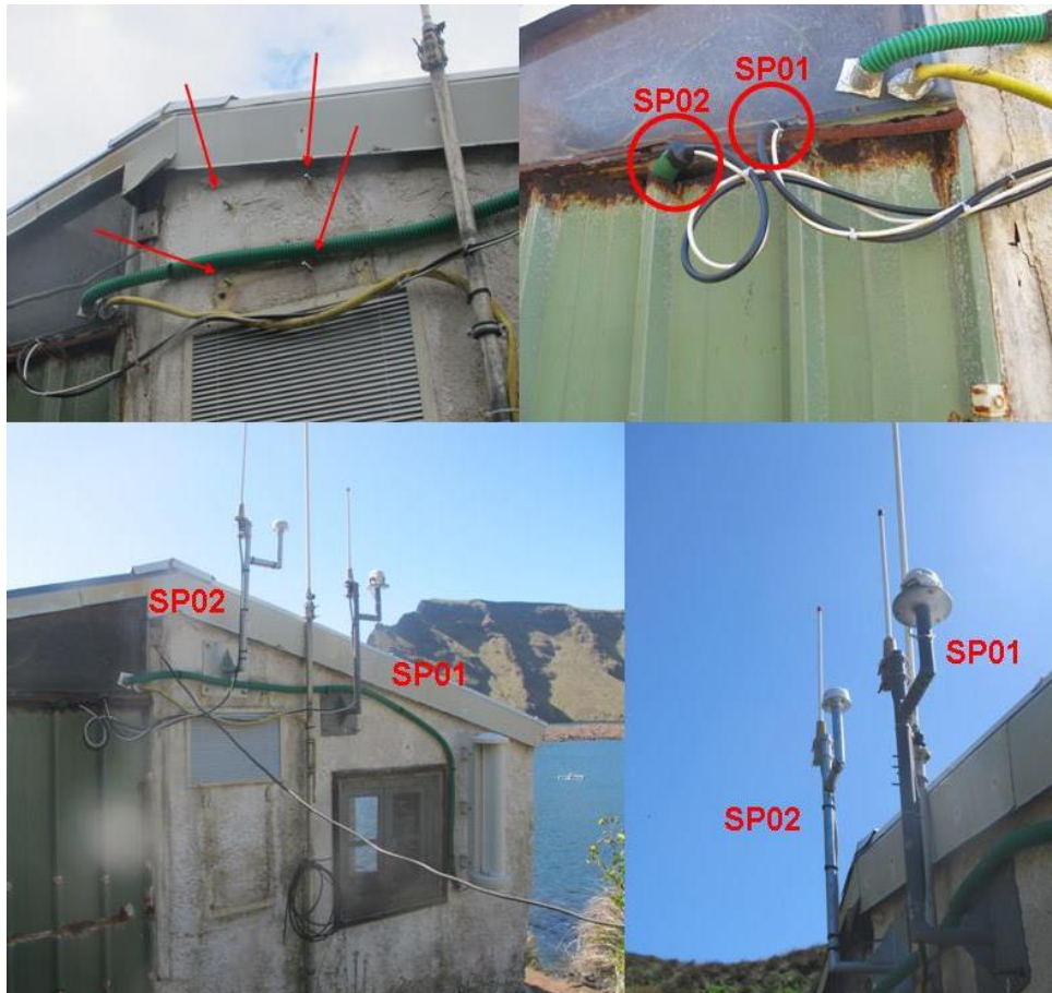
Figure 7 : Détails installation structure supportant les 2 antennes de la station SP02. Points de fixation scellés et passage des câbles.
