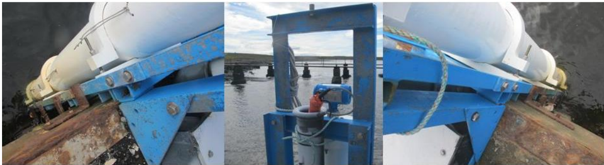
Figure 13 : Etat structure marégraphe PAF
