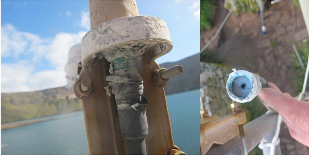
Figure 8 : Connexion antenne ARGOS SP01 corrodée.
