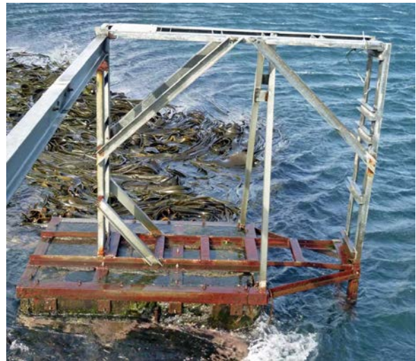
La structure qui supportait le tube de tranquillisation est en bien mauvais état
