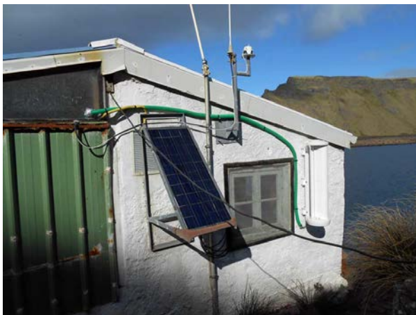
Panneau Solaire et Eolienne
