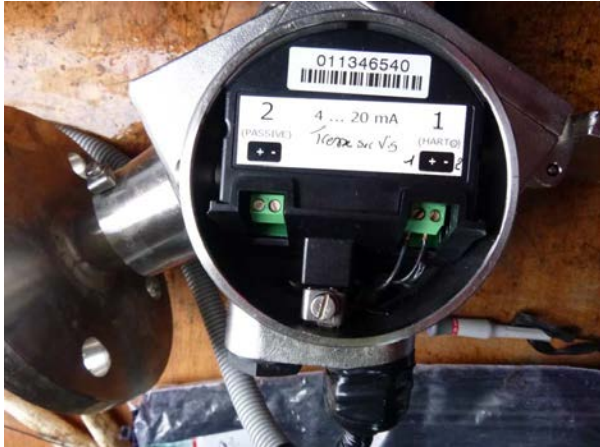
Câblage du radar Optiwave (le fil 0v ou 2 ou - est repéré par un scotch noir)
