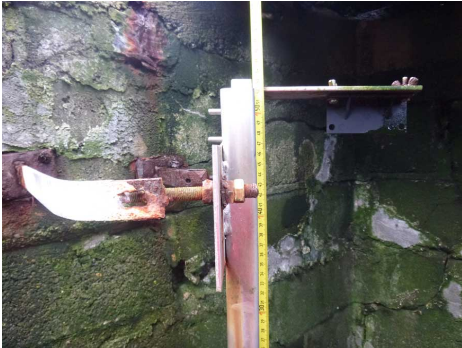
Les pattes de fixations corrodées de l'échelle de marée sont bien corrodées, il faudrait les refaire.
