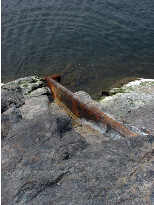
Tube de protection du câble au niveau de la banquette
