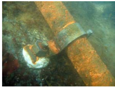
Fixation du tube de protection du câble marégraphique
