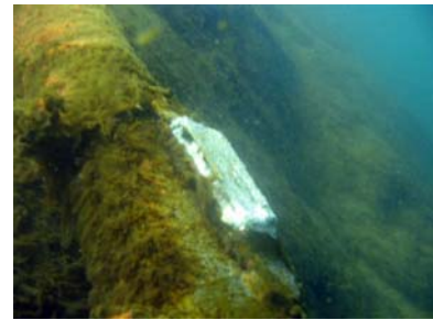
Anode sacrificielle protégeant le tube de protection en acier
