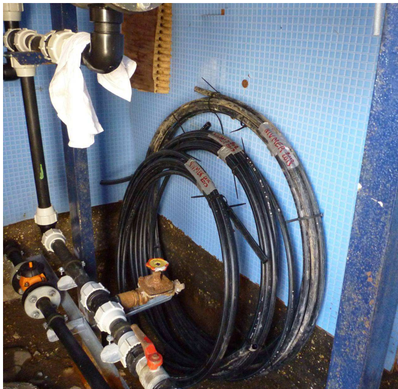
PET dans le local de la station
