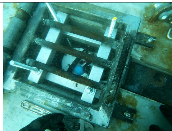
Les tiges filetées n'ont pas pu être coupées faute de temps (« elles ne dépassent pas de la poignée de la grille ») => à contrôler dès que possible
