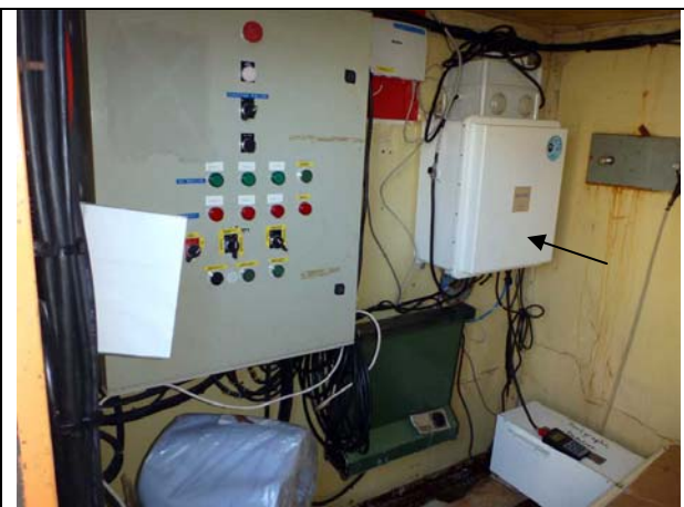
La nouvelle station marégraphe est fixée au mur dans la station de pompage (en lieu et place de l'ancienne)
