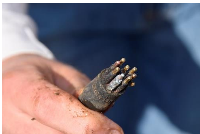
Connectique oxydée du marégraphe à pression
