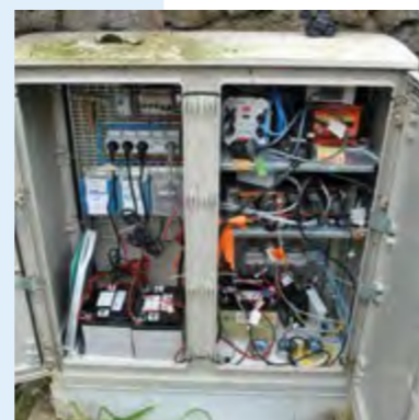
En haut : sismomètres de Crozet En bas : armoire d'Amsterdam
