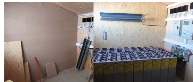
Remplacement du parc batterie
