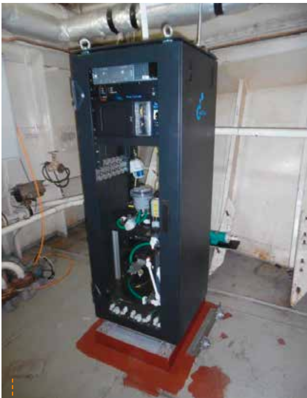
Figure 12 - Baie OceanPack en cours d'installation (il manque encore des capteurs et toute la tuyauterie) dans l'ancien local sondeur.
