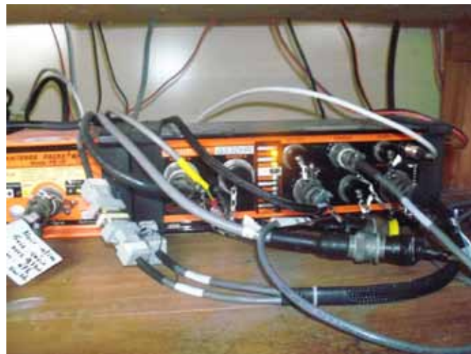
Figure 2 : L'acquisition Q330 dans l'abris d'Amsterdam. The Q330 system in the shelter at Amsterdam. © Follezour J.
