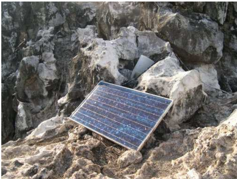
Panneau Solaire de la station GPS ©A.GUILLOT-CNRS
