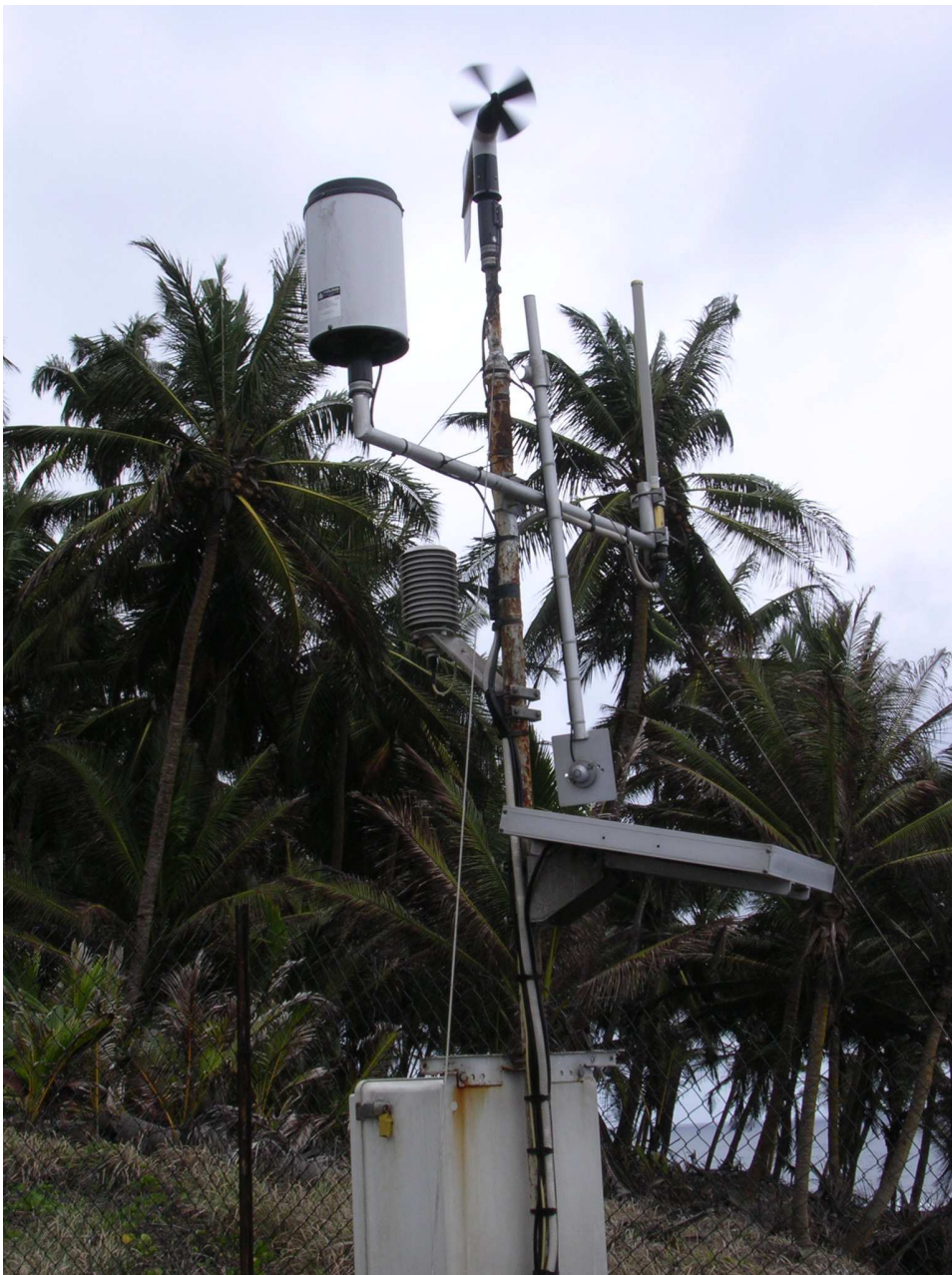
Photo de la station avant intervention, on aperçoit le support cassé du pyranomètre.
